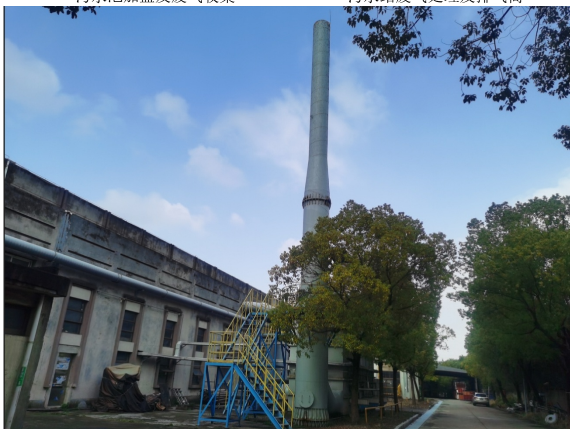
涂层废气 RTO 排气筒
