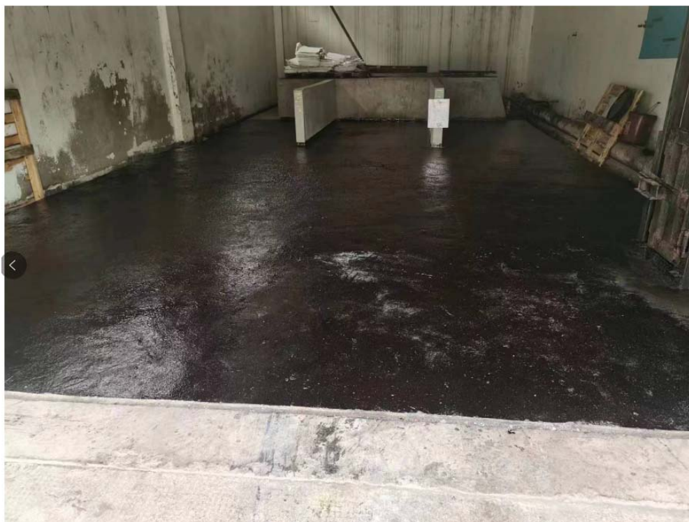
图 4.1-2 危废暂存间现场照片
