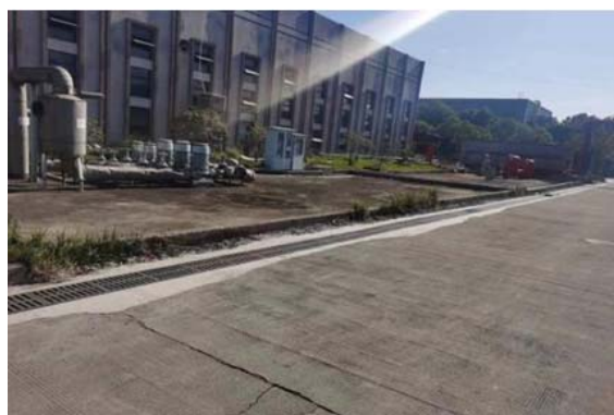
地下事故应急池
