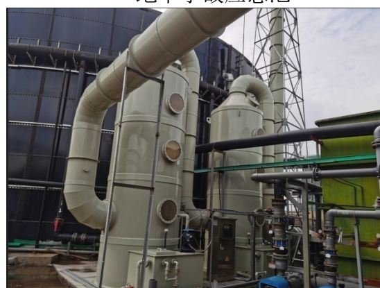
污水站废气处理及排气筒
