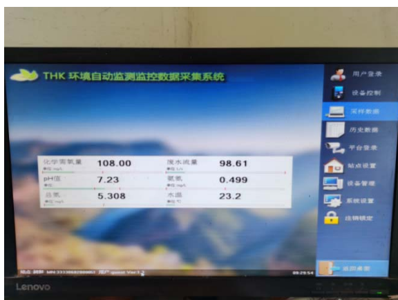
废水水质在线监控设施
