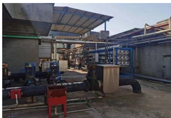
污水站及 RO 膜中水回用系统
