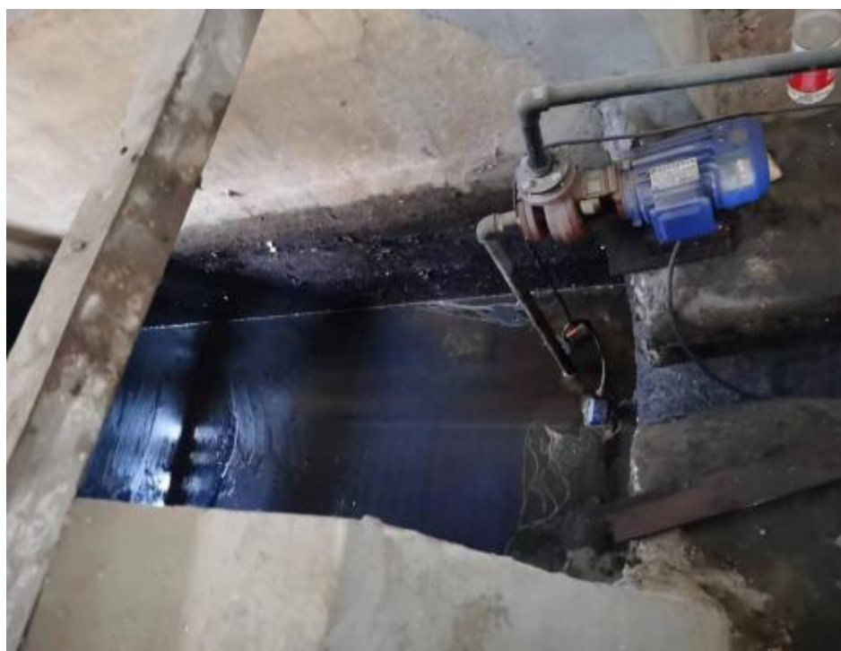
图 4.1-3 危废暂存间收集沟
