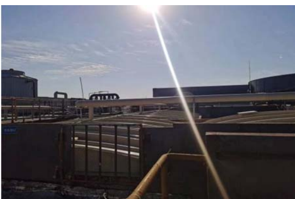
污水池加盖及废气收集
